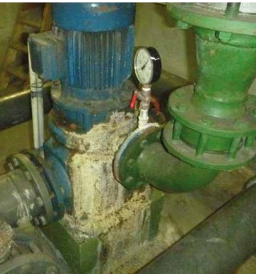
Umwälzpumpe Sportbecken im Dauerbetrieb
