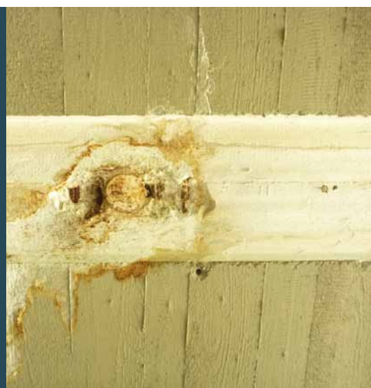
Deckenlampe, ungeklärte Undichtigkeit im Eingangsbereich
